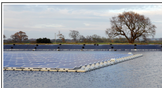
100 kW p teljesítményű úszó naperőmű; a Ciel & Terre cég Hydrelío rendszere ( http://goo.gl/bIP9wu )
