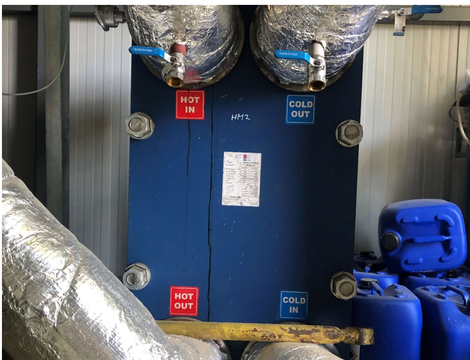
A Szetáv geotermikus vízvezetékei, Magyarország
